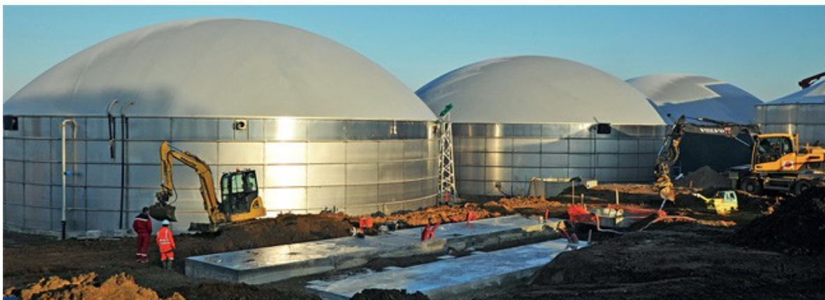
Usine Agrigaz à Vire Normandie
